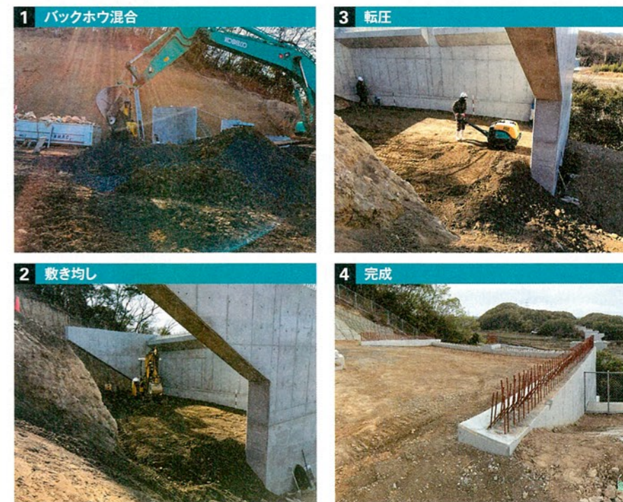
1 現場発生土に地盤改良用鉄鋼スラグを混ぜ合わせる。3軸圧縮試験の結果から、混合率は33%。セメント系固化材と同様、バックホウで作業できる。2 25cm巻き出し・20cm転圧を繰り返す。セメント系固化材のような粉体ではないため、作業性は良いという。3 敷き均し・転圧を繰り返し、施工を終えたところ
