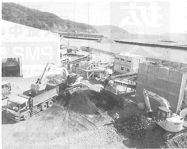
鉄鋼スラグを用いるカルシア改質土を活用した釜石市の災害廃棄物処理事業
