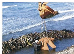
北海道増毛町の海岸にビバリーユニットを設置（平成16年）
