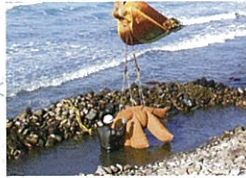
平成16年、北海道増毛町の海岸に「ビバリーユニット」を設置
