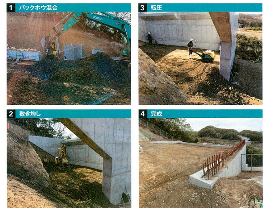
1 現場発生土に地盤改良用鉄鋼スラグを混ぜ合わせる。3軸圧縮試験の結果から、混合率は33%。セメント系固化材と同様、バックホウで作業できる。2 25cm巻き出し・20cm転圧を繰り返す。セメント系固化材のような粉体ではないため、作業性は良いという。3 敷き均し・転圧を繰り返し、施工を終えたところ
